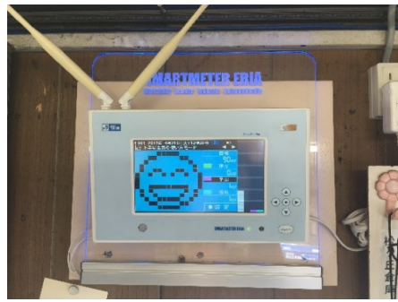
・スマートメーターで電力デマンド表示
