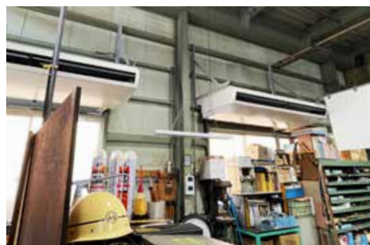
第3工場に合計三台を新しく設置。社員の熱中症も防げる。
