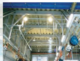
<作業場内LED照明>
