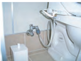
＜トイレ洗浄に活用＞
