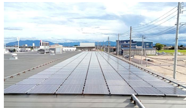
新潟センターの太陽光発電パネル
