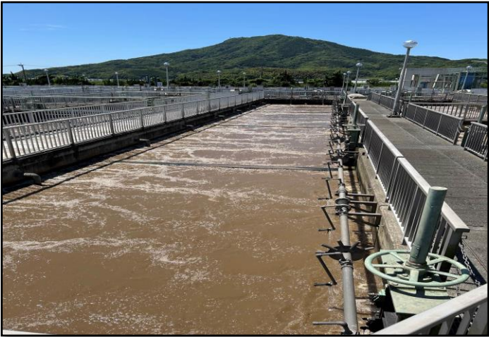
エアレーションタンク
